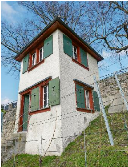
Vorzustand mit Putzschäden.
